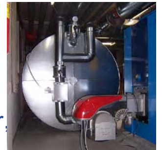
Neue Heizzentrale mit BHKW
